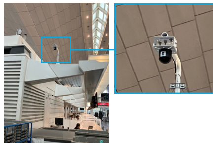
LiDAR設置状況
