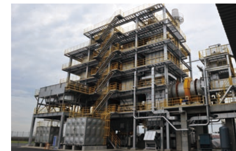
焼却プラント
