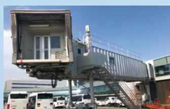
羽田空港旅客搭乗橋における施工検証結果 PBB(Passenger Boarding Bridge) 57番
